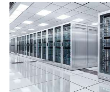
データセンター（高速PC空調）
