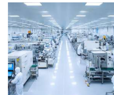
半導体工場（クリーンルーム空調）
